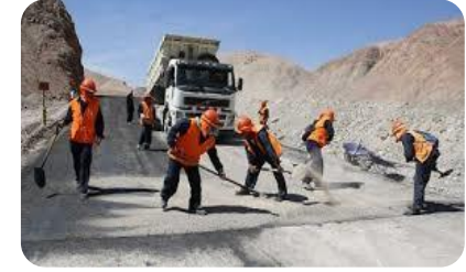
Obras sin funcionamiento
