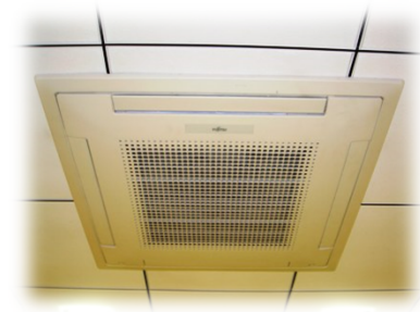
Sistema aire acondicionado
