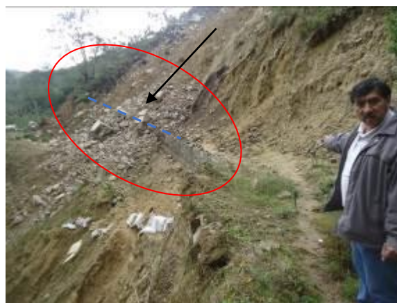
Vista del 2 do tramo entubado colapsado por derrumbe del talud.
