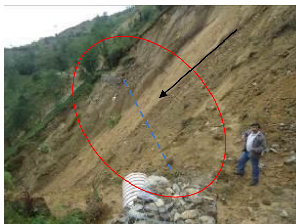
Vista del 1 er tramo entubado colapsado ocasionado por derrumbe del talud.
