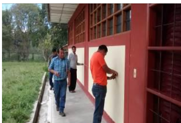
Medición de las aulas los cuales son menor al área del perfil
