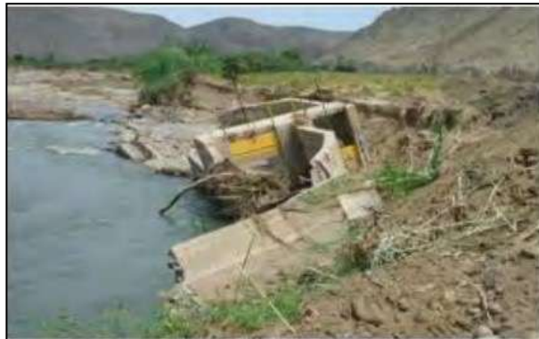
UP: Infraestructura de Riego
