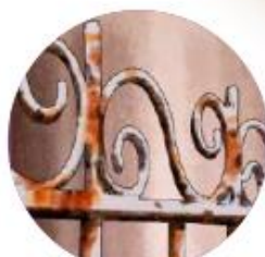
1. Oxidación en rejas de metal
