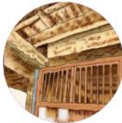
3. Deformación de estructura por humedad
