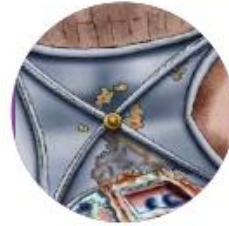
4. Filtración de agua en techos
