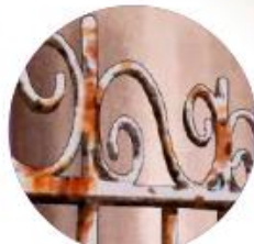
1. Oxidación en rejas de metal
