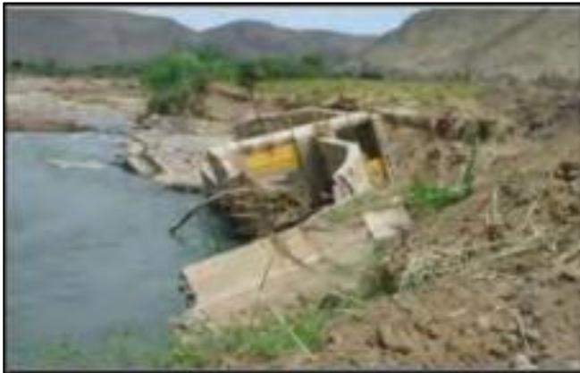
UP: Infraestructura de riego
