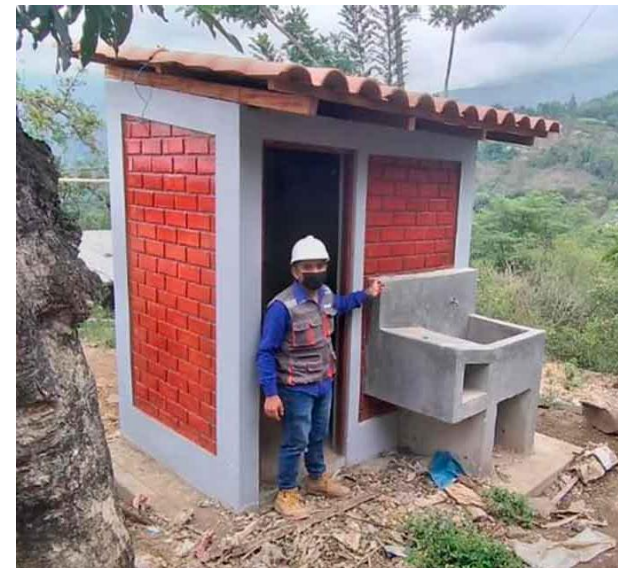
Sistema de disposición sanitaria de excretas (UBS)
