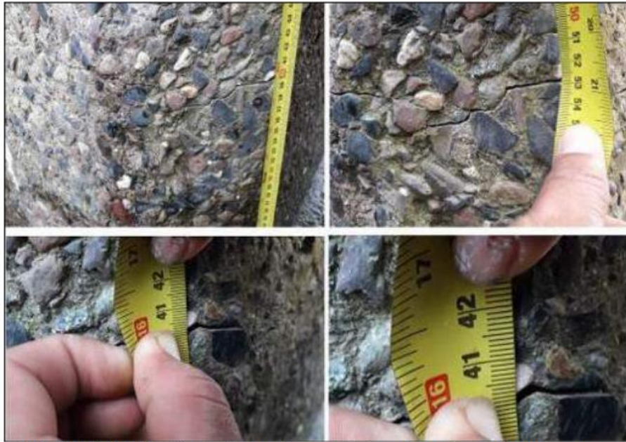
Foto 7, 8, 9 y 10: Medición de Fisura en Pilar, existentes, algunas llegan a 3mm de espesor
