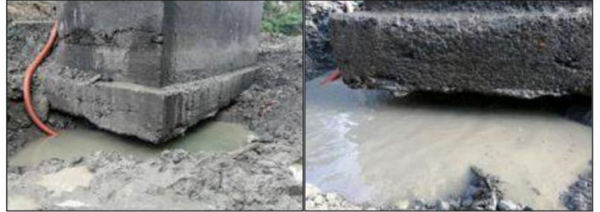
Foto 1 y 1: Producto de un intenso proceso de erosión fluvial se viene desarrollando los problemas de socavación en la base del pilar del puente.
