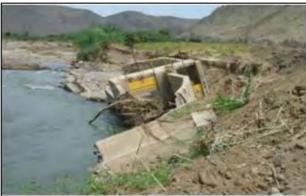
UP: Infraestructura de Riego
