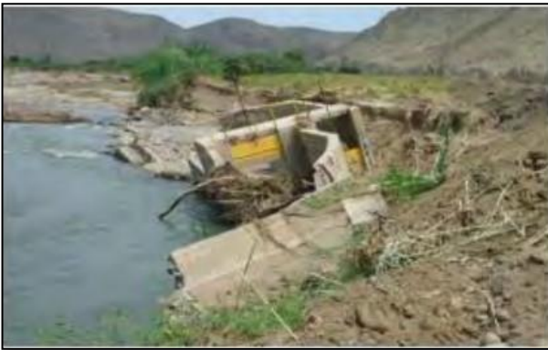
UP: Infraestructura de Riego
