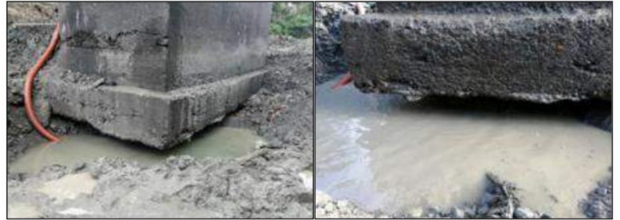
Foto 1 y 1: Producto de un intenso proceso de erosión fluvial se viene desarrollando los problemas de socavación en la base del pilar del puente.
