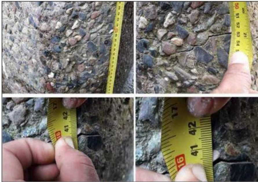
Foto 7, 8, 9 y 10: Medición de Fisura en Pilar, existentes, algunas llegan a 3mm de espesor
