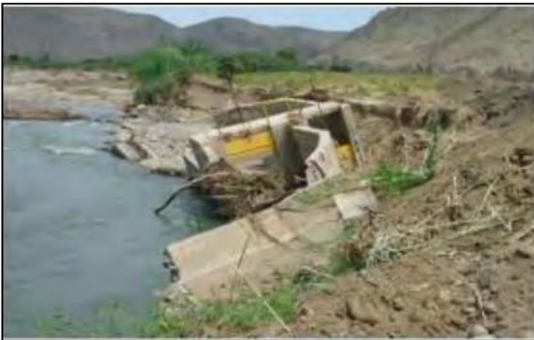
UP: Infraestructura de Riego
