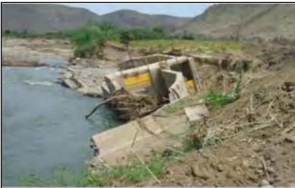
UP: Infraestructura de Riego
