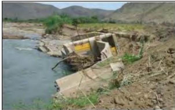
UP: Infraestructura de Riego
