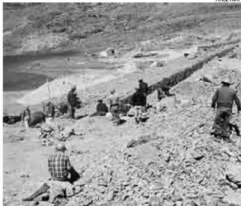
MANO DE OBRA. Sesenta campesinos obtuvieron trabajos temporales en la construcción de los muros que retendrán el agua.
