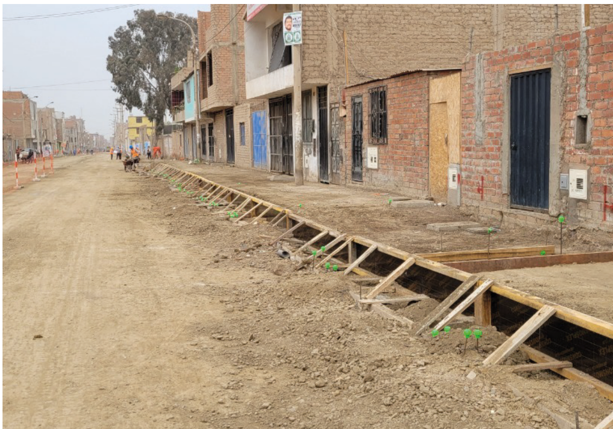
Foto: Lima: Creación de la infraestructura vial y peatonal de la Av. San José, tramo: Av. El Sol de Naranjal – Av. Los Alisos, distrito de San Martín de Porres - provincia de Lima. CUI: 2354896.
