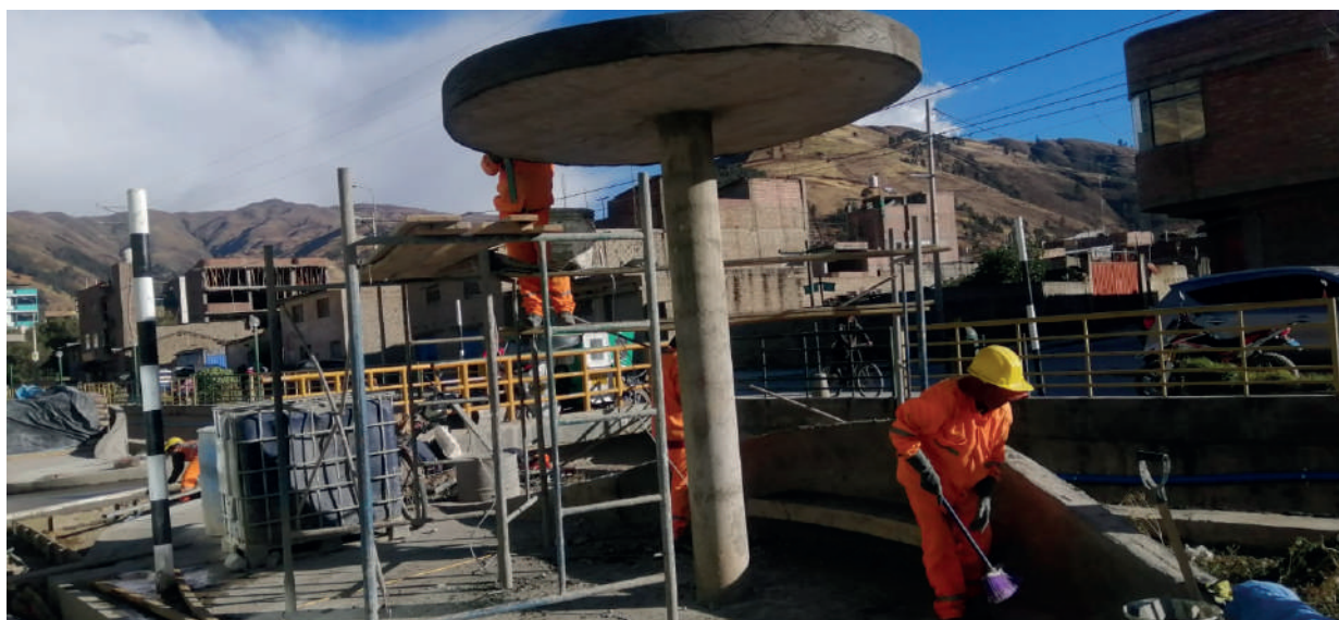
Foto: Huancavelica - Mejoramiento del servicio vial y peatonal de la Alameda Los Héroes Tramo prolong. Centenario – vía de Evitamiento, distrito de Daniel Hernández, provincia de Tayacaja. CUI: 2251217.
