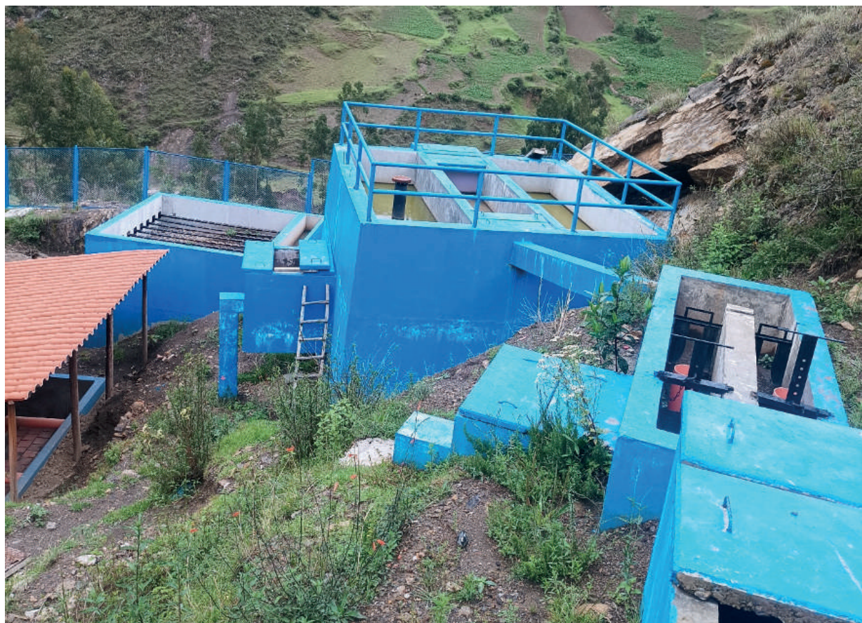
Foto: Áncash - Ampliación de los servicios de agua potable y saneamiento de los Centros Poblados de Chuyas y Viñauya, distrito de Pomabamba, provincia de Pomabamba. CUI: 2343945.
